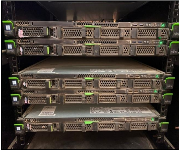
Rack Servers: Mini Cluster
