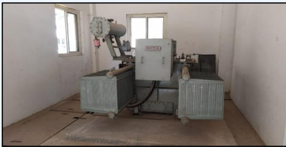
चित्र 3: इंडोर 11/0.415kV(800kVA) ट्रांसफार्मर
